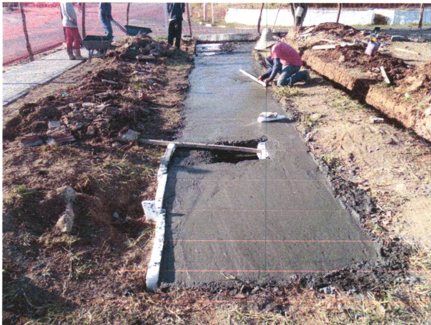
Foto 12 - CONCRETO FCK = 25MPA, TRAÇO 1:2,3:2,7 (EM MASSA SECA DE CIMENTO/ AREIA MÉDIA/ BRITA 1) - PREPARO MECÂNICO COM BETONEIRA 600 L. AF_05/2021
